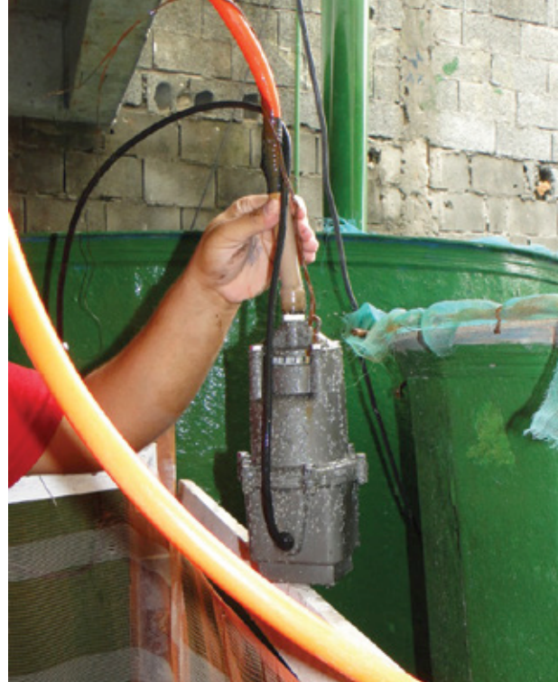
Bomba instalada na mangueira leva água da chuva a todos os andares da obra
